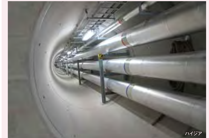
地下の共同溝(地域冷暖房プラント)
